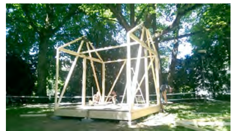
Aufbau einer KIUP!box im Wittelsbacher Park
